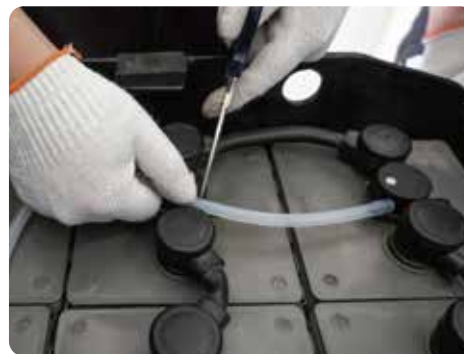
注液阀连接水管长度为注液塞间实际尺寸加3-5mm
